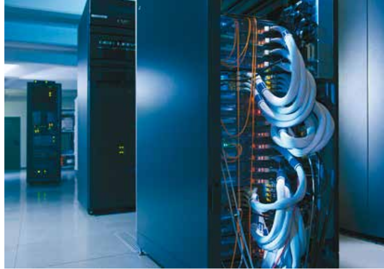
Modernes Rechenzentrum: Die Digitalisierung vollzieht sich in immer schnellerer Geschwindigkeit
